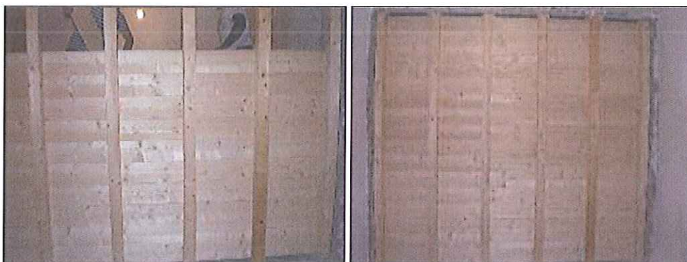
Figura 2 – Posa del primo assito sull'orditura di travi posizionate in verticale all'interno della camera ricevente.
