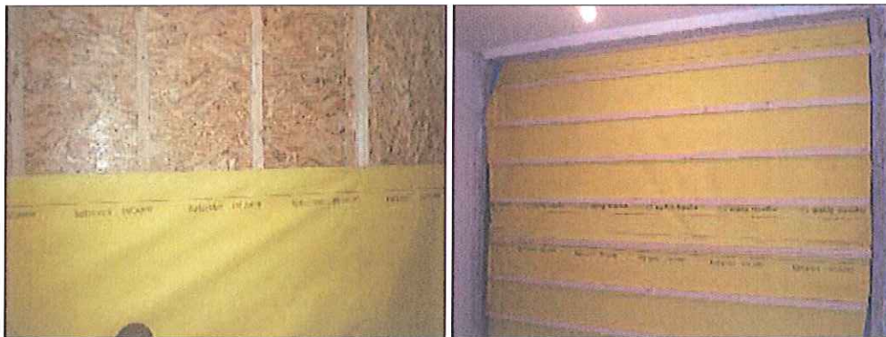
Figura 6 – Posa dei listelli di ventilazione e del telo sottotegola a sinistra; posa dei listelli portategole a destra.
