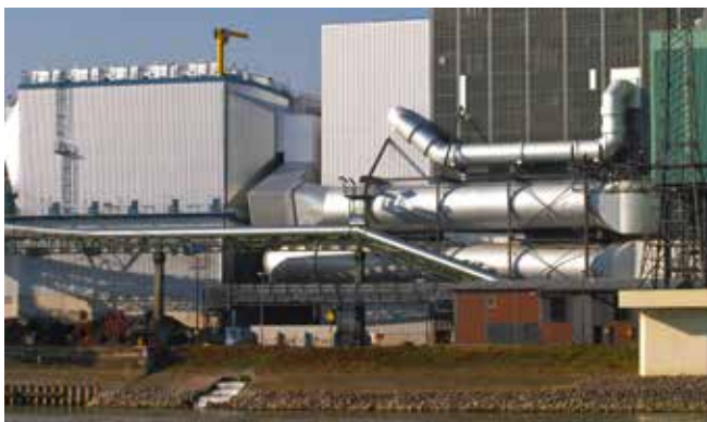
Impianto a carbone GKM Mannheim, Germania
