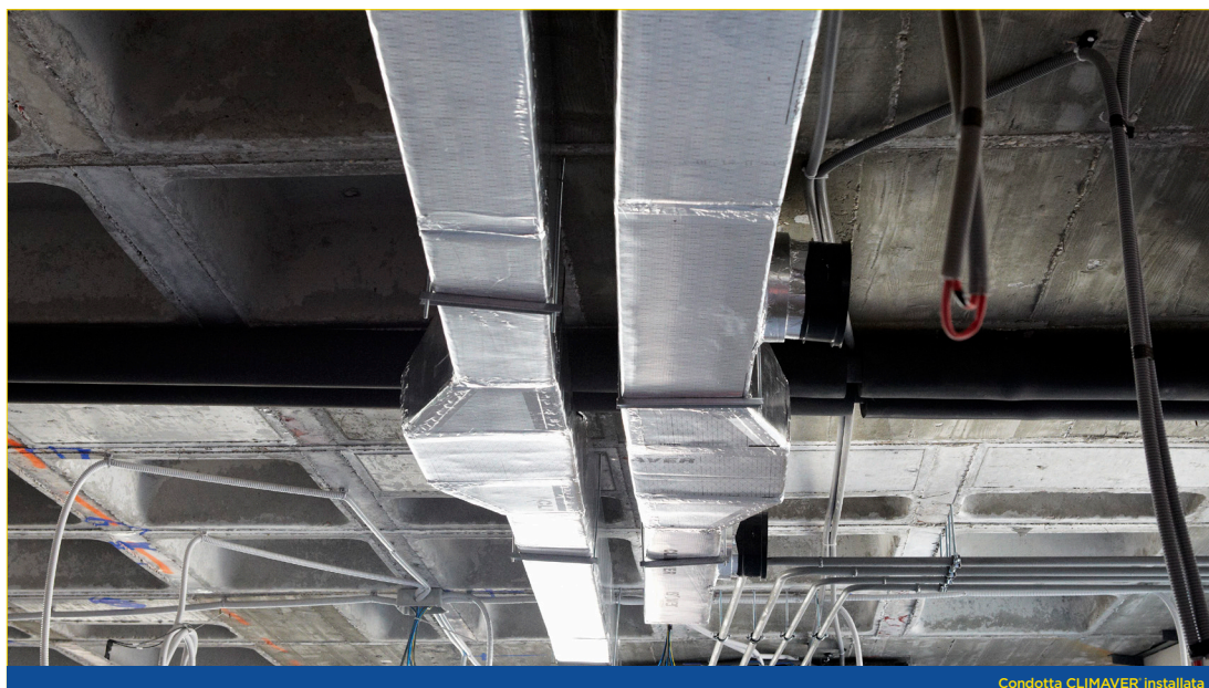
Condotta CLIMAVER installata
