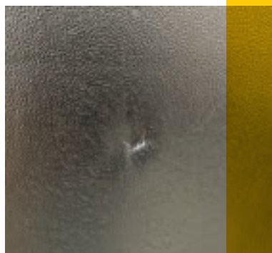
Superficie della condotta a seguito dell'impatto da corpo duro
