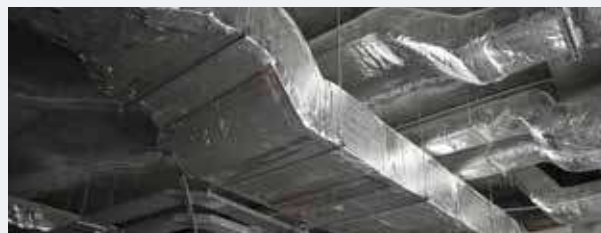
Canale metallico isolato esternamente
